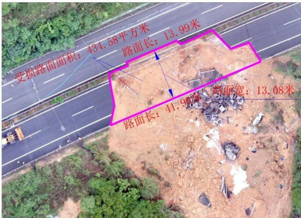
图 3 塌方灾害正射影像图
